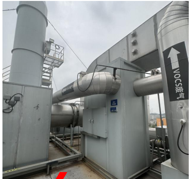
后处理工序废气催化燃烧设施
