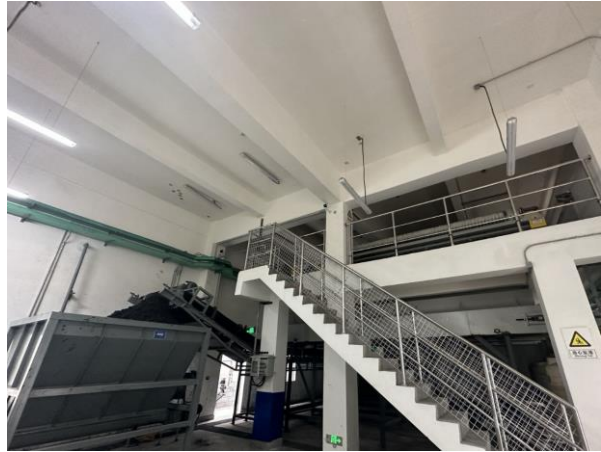
污泥压滤车间
