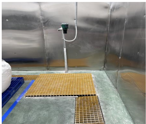
废 NMP 暂存间截流沟、收集井
