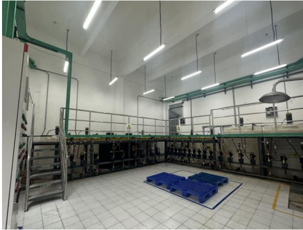
污水处理站加药车间
