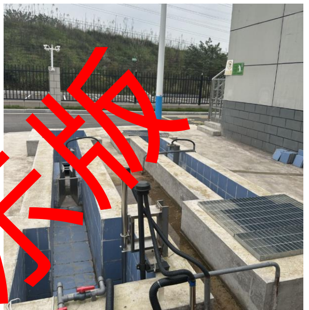
生产废水总排放口 (DW001, 左)、 生活污水总排放口 (DW002, 右)
