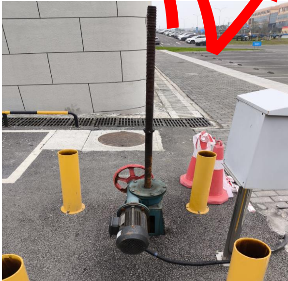
雨水排放口 1 及其切换阀（西南角）
