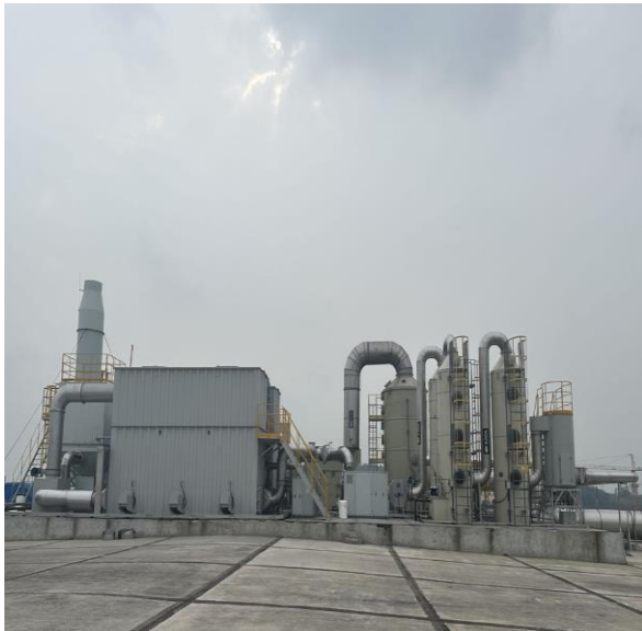
电芯厂房 1 的后处理工序废气处理设施
