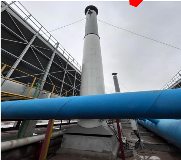
3#导热油炉烟气排气筒(DA042)
