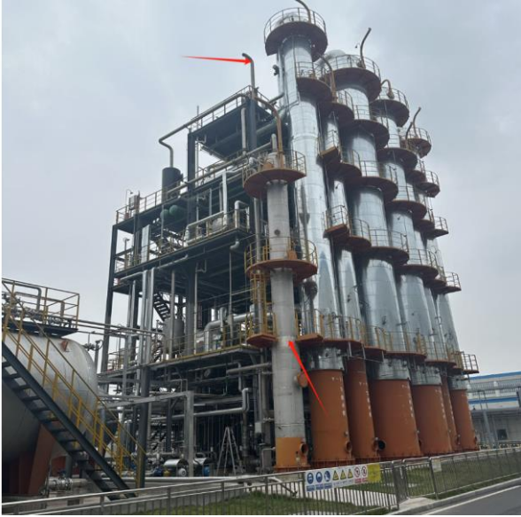
NMP 精馏废气处理设施及排气筒 (DA037)
