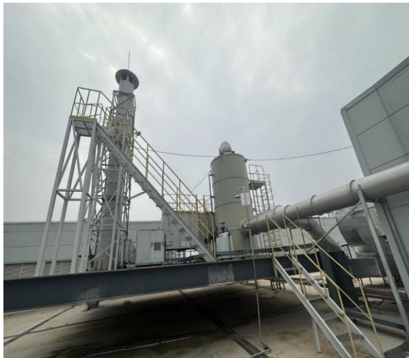
原料仓实验室废气处理设施(碱洗+活性炭)及排气筒(DA043)
