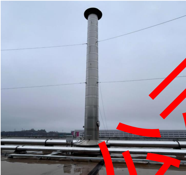
3#、4#锅炉烟气排气筒 (DA039)
