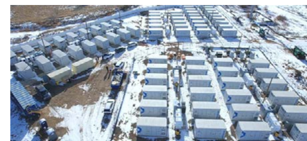
海辰储能科罗拉多州储能项目
