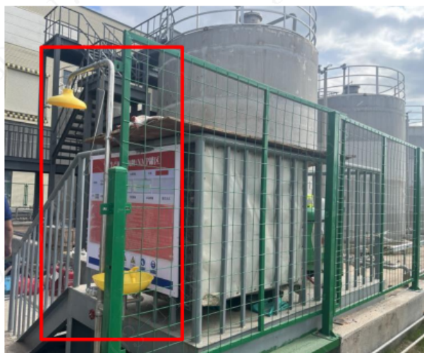
NMP 储罐安全告知牌，洗眼装置
