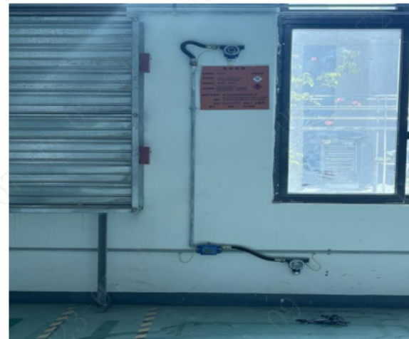
危废仓可燃气体泄漏监测装置
