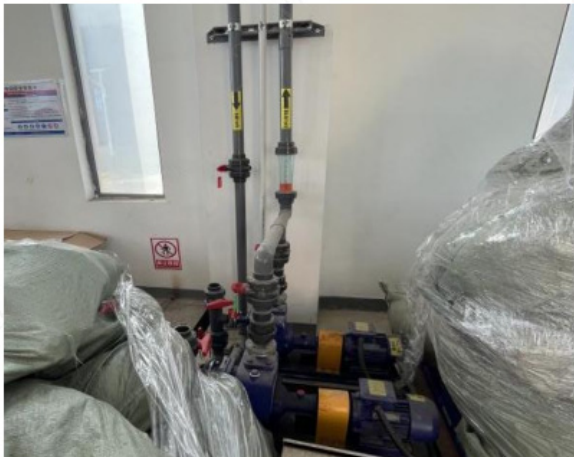
应急事故池水泵
