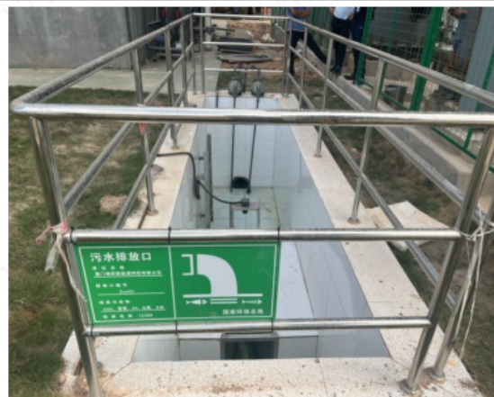
废水排放口标识
