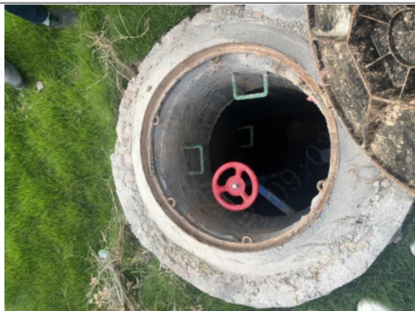
雨水总排口阀门
