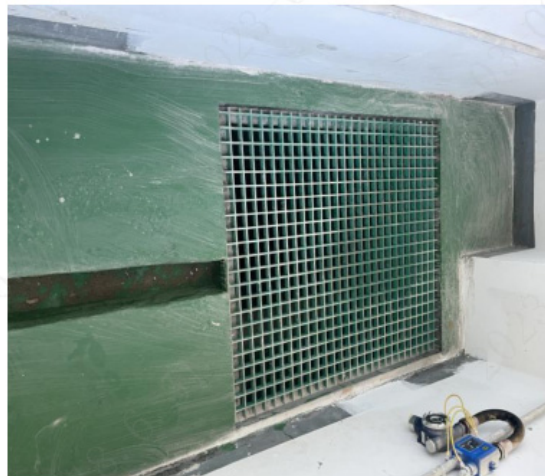
危废仓导流沟和废液收集池
