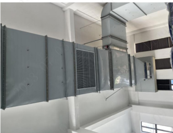
危废仓废气收集装置
