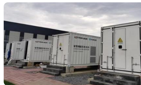
河南焦作用户侧储能项目 4.8MW/18.08MWh
