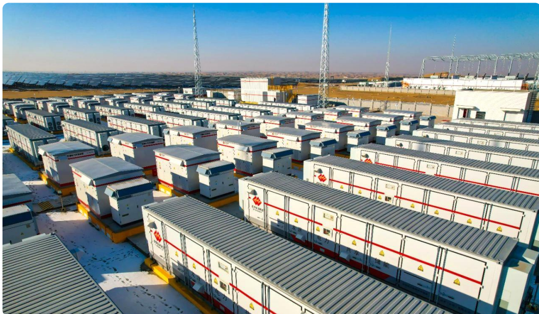
宁夏腾格里沙漠新能源基地一期百万千瓦光储 100MW/200MWh
