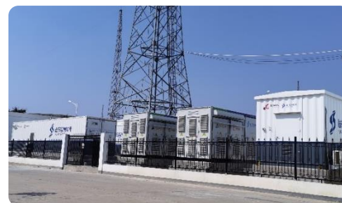
河南濮阳龙丰纸业储能项目 5MW / 14.9MWh
