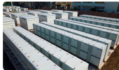
重庆铜梁淮远集中式储能电站 100MW/ 200MWh
