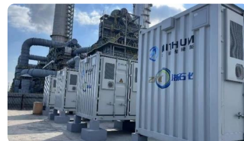
浙石化储能项目 10MW/20MWh
