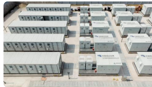
梅州电网侧储能电站项目 70MW/140MWh
