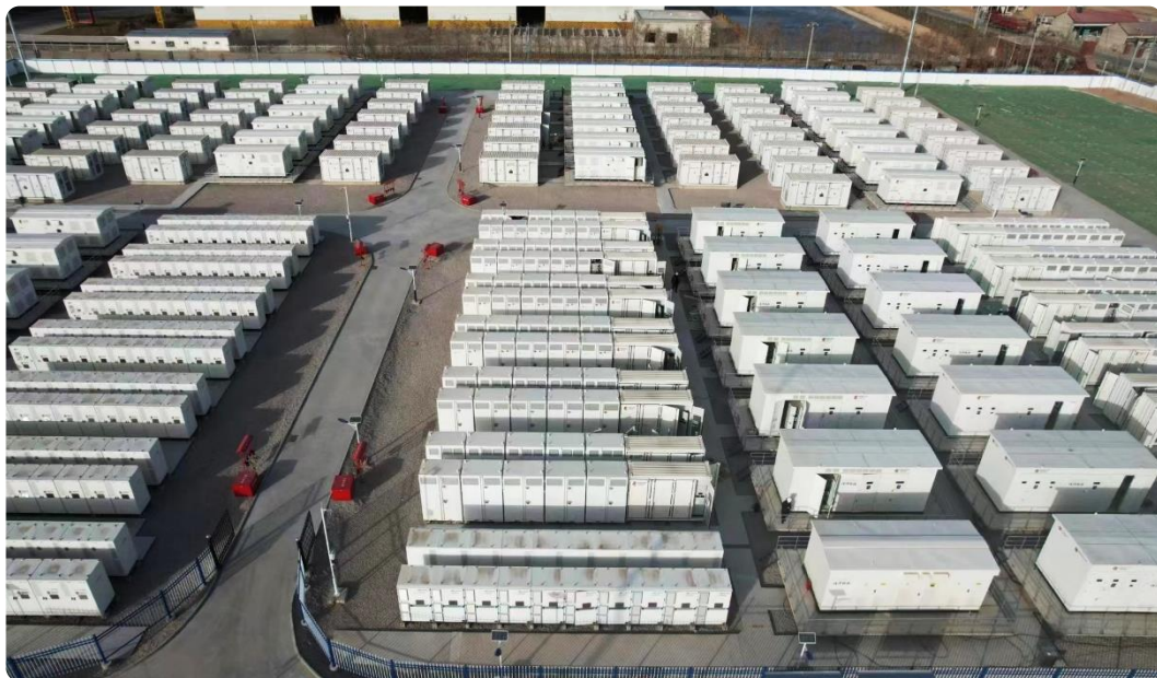
宁夏穆和独立储能电站项目 200MW/400MWh
