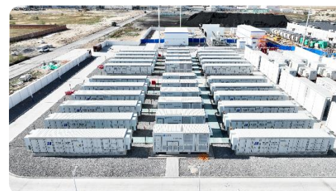
内蒙古上都百万千瓦风储 20MW/40MWh
