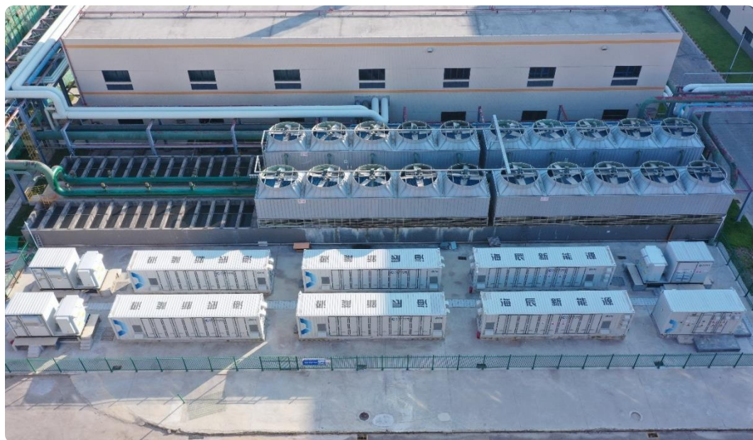
广东珠海化工企业储能项目 7.5MW/21.5MWh
