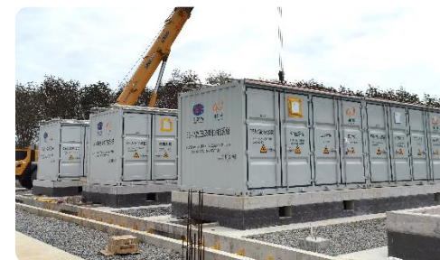
海南白沙光储项目 25MW/ 50MWh
