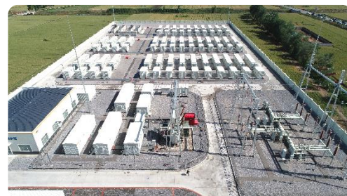
山东鄞城集中式共享储能电站 100MW / 200MWh
