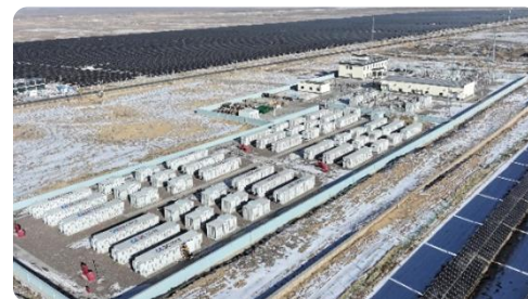
甘肃张掖光储项目 60MW/120MWh
