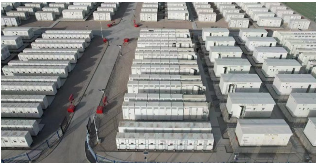
电网侧 & 独立储能 宁夏穆和独立储能电站项目
