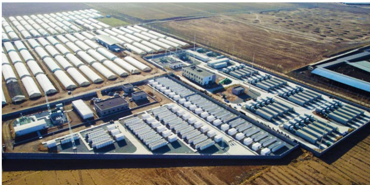
电网侧 & 独立储能 宁夏吴忠分布式模块化储能电站
