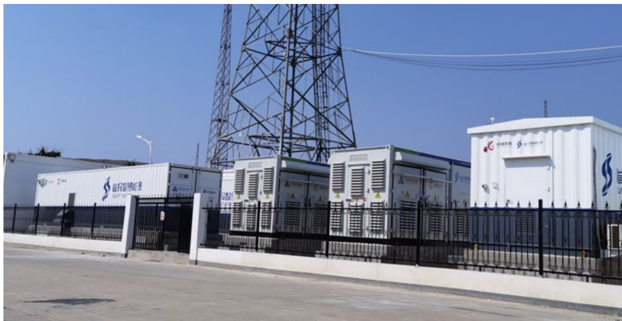
用户侧储能 河南濮阳龙丰纸业储能项目
