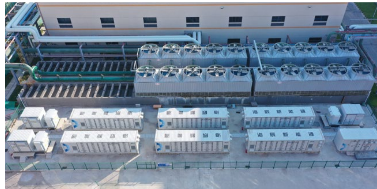
用户侧储能 广东珠海化工企业储能项目
