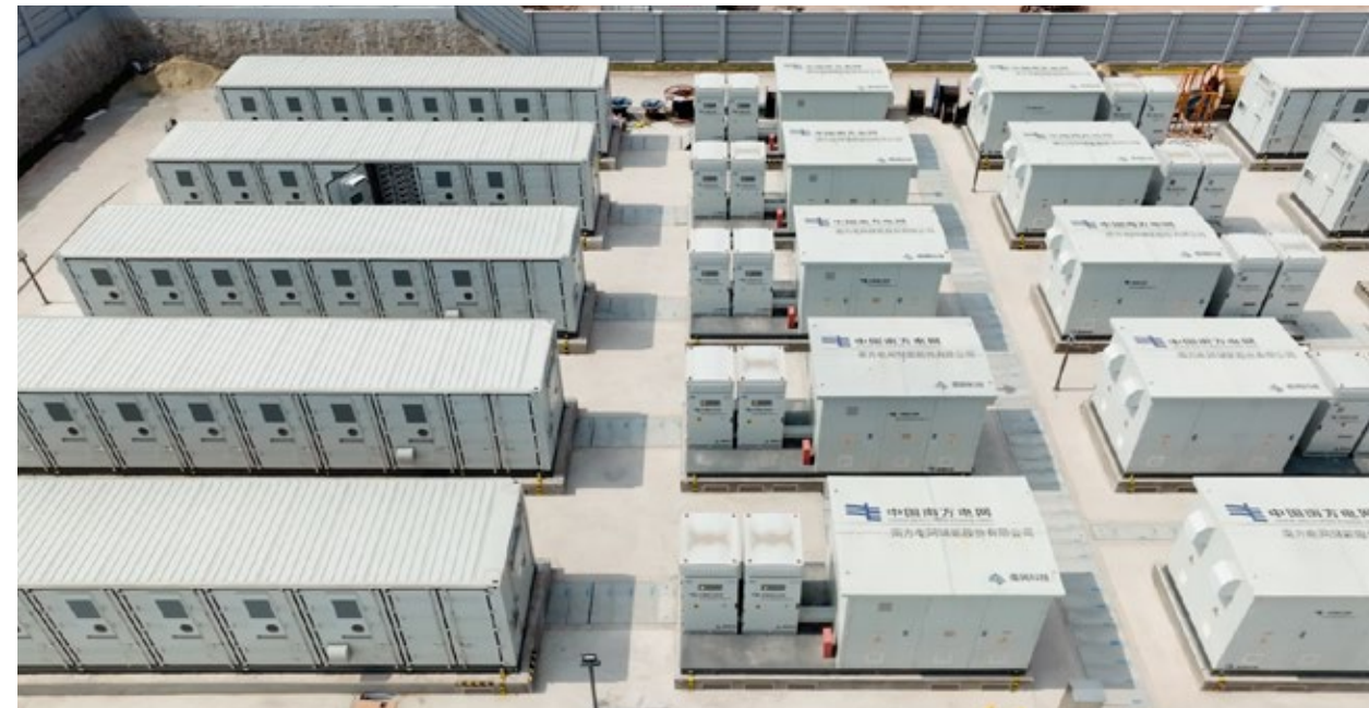
电网侧 & 独立储能 广东梅州电网侧储能电站项目
